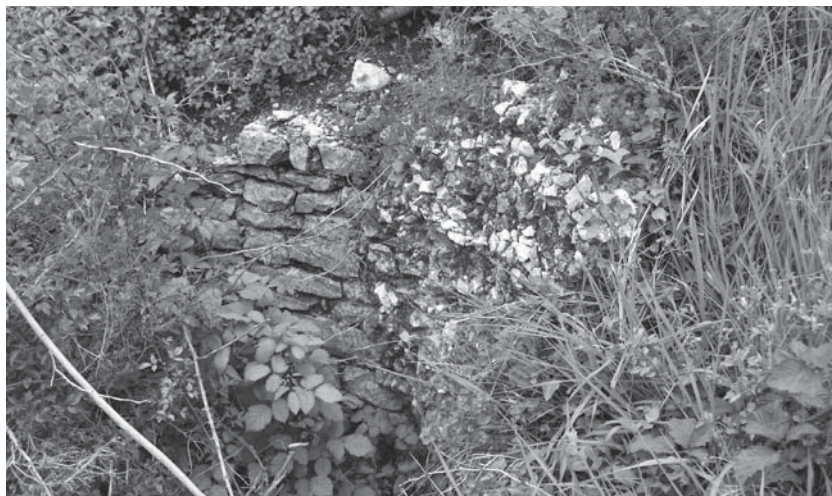
Sl. 6. Segment zida vodospreme na kojem je vidljiva tehnika gradnje (fotografirao Vedran Kos)
